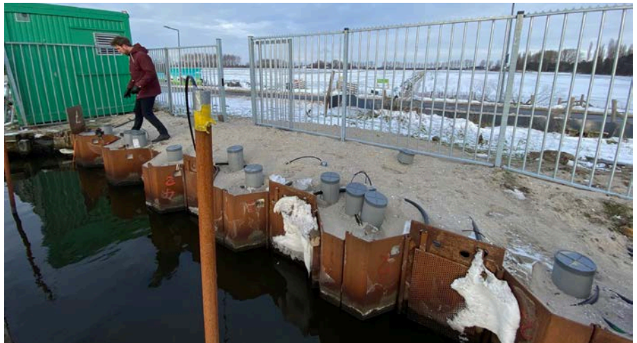
De energiedamwand werkt ook als het vriest. (Foto: CRUX Engineering)
